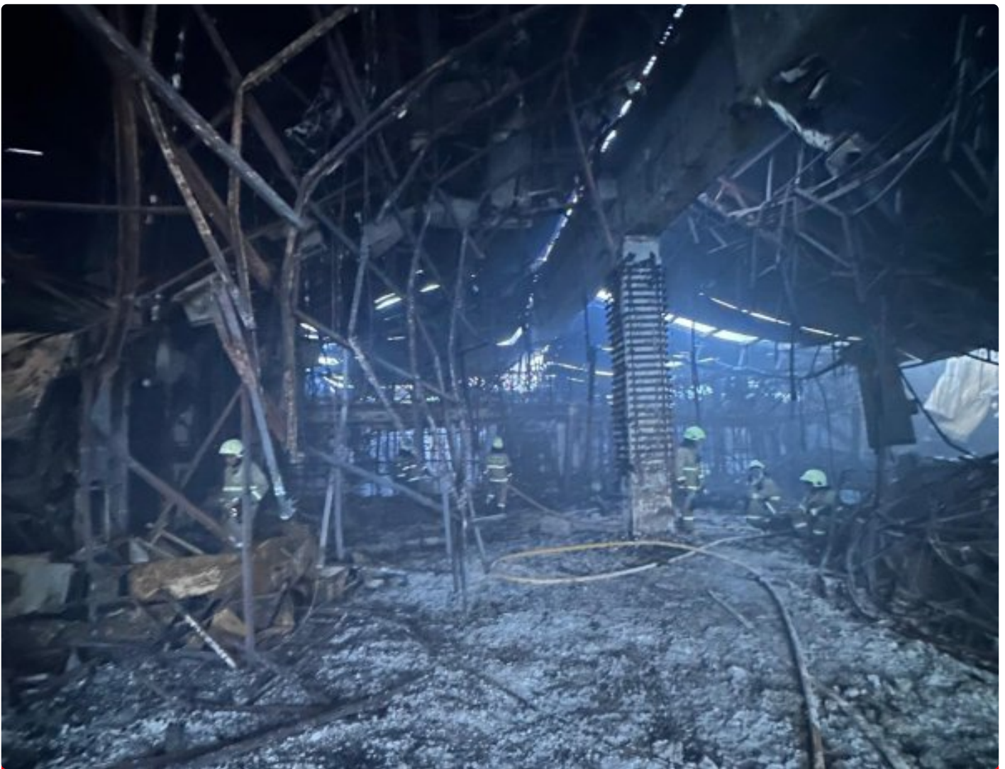
Glodok Plaza yang Hangus Terbakar
